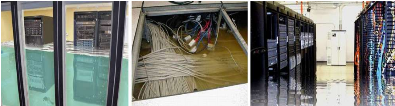
Figura 5. R. Datacenter, PandoraFMS y Computerworld, "Ejemplos de Centros de Datos inundados, (a) ¿RTO vs RPO?, (b) Octopods flood, (c) calor y lluvias entre los grandes desafíos para la transformación digital del centro de datos," 2013. [Fotografía]. Disponible en: https://re-visitadadcenter.wordpress.com/2013/12/12/cual-es-la-diferencia-entre-el-rto-y-rpo/ https://pandorafms.com/docs/index.php?title=File:Octopods_flood.jpg y https://computerworldmexico.com.mx/calor-y-lluvias-entre-los-grandes-desafios-para-la-transformacion-di-gital-del-centro-de-datos [Consultado en junio 22, 2020].
