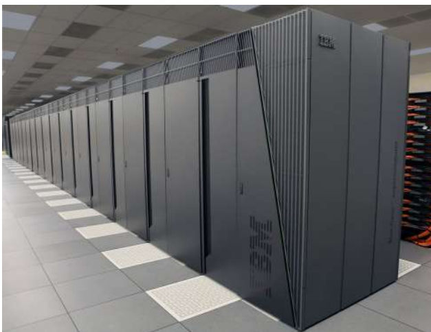
Figura 3. Pixabay, "Unidad de Control Computadora," 2018. [Fotografía]. Disponibile en: https://www.pexels.com/photo/airport-business-cabinets-center-236093/ [Consultado en septiembre 18, 2019].
